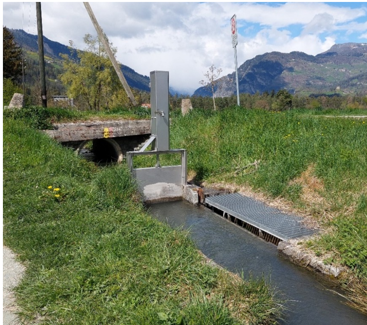
Abbildung 11: Einlauf in die Mischabwasser-Entlastungsleitung beim Damm Montéwald (Foto: HOLINGER AG, 2024)
